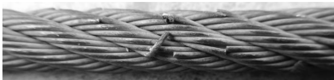
Abbildung 4: vorstehender Draht, der mit einer Zange durch mehrmaliges Umbiegen entfernt werden sollte
